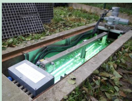
Lampa UV na terenie oczyszczalni w Nałęczowie
