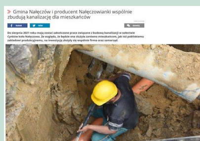
System kanalizacji we wsi Cynków
