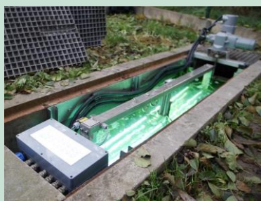
Lampa UV na terenie oczyszczalni w Nałęczowie
